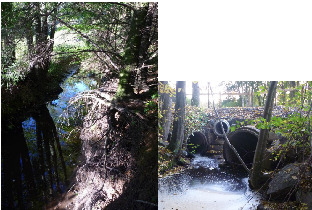
Figur 13. Kraftigt eroderad bäckkant (tv.) nedströms Strömsberg och stor dagvattenledning uppströms vid Strömsberg, dagvattenledningen längst till höger (th.)
