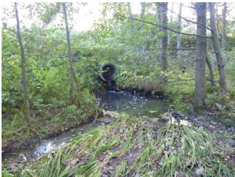
Figur 14. Dagvattenledningen från Verktgsvägens industriområde har en i hög grad synlig påverkan.
