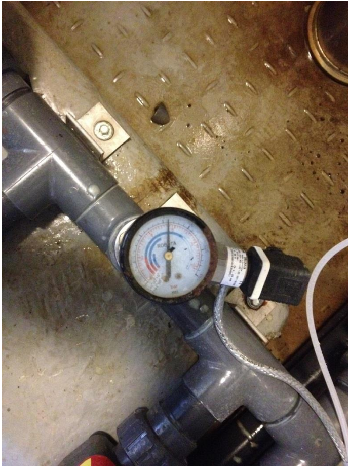
Tryckmätare kopplad till frekvensomformare, frekvensomformare inställd för 5,5 bar
