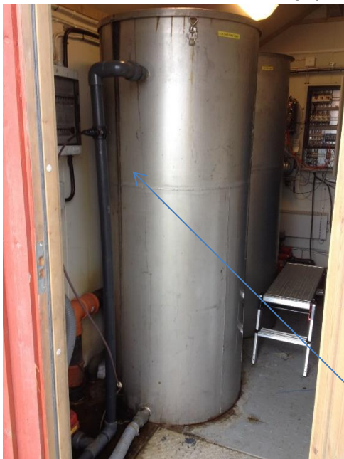
Oxidationstank med luftinblås i botten och kaliumpermanganatinjektion i vattenröret till oxidationstanken.
