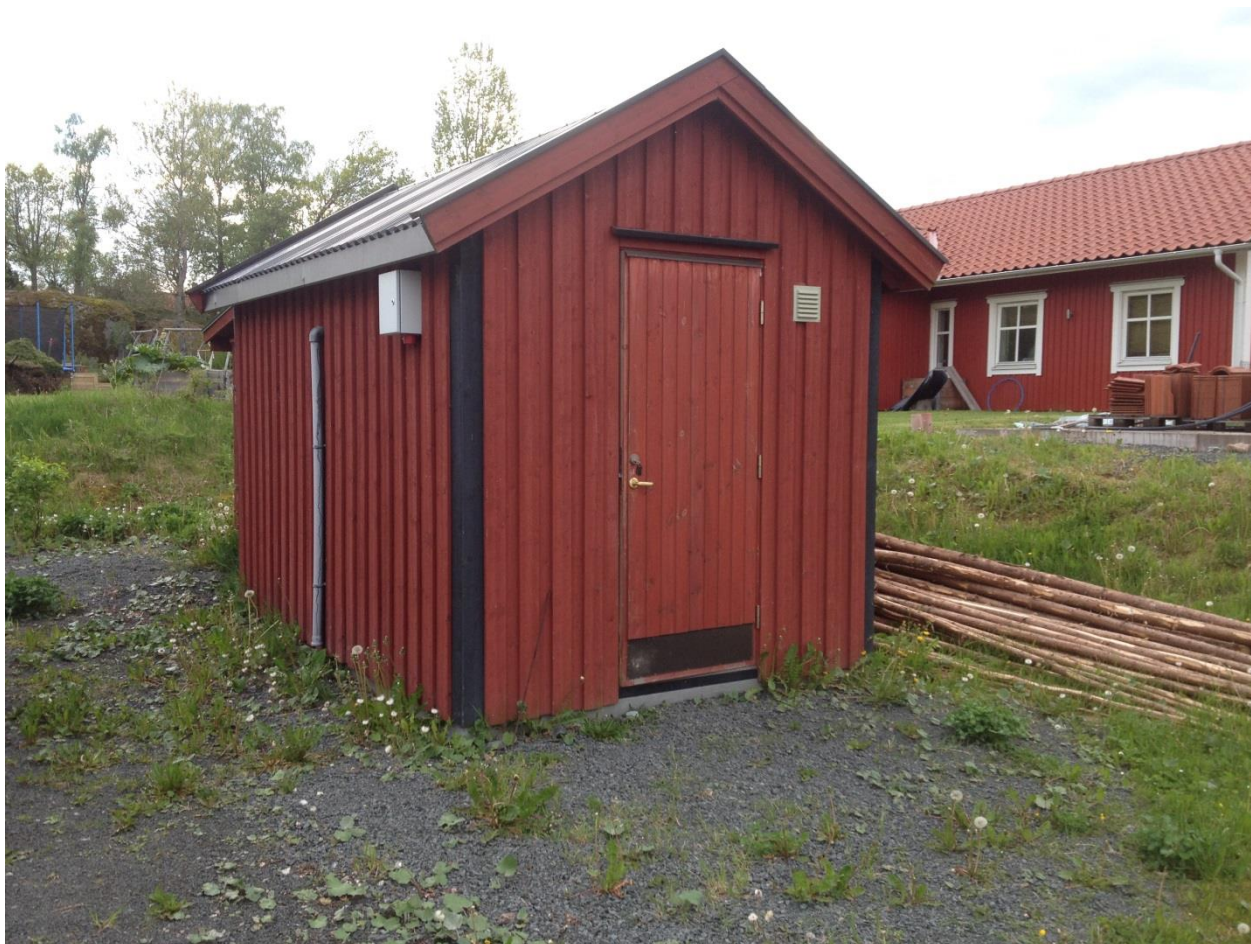
Vattenverk med 30 m 3 vattenreservoar under huset
