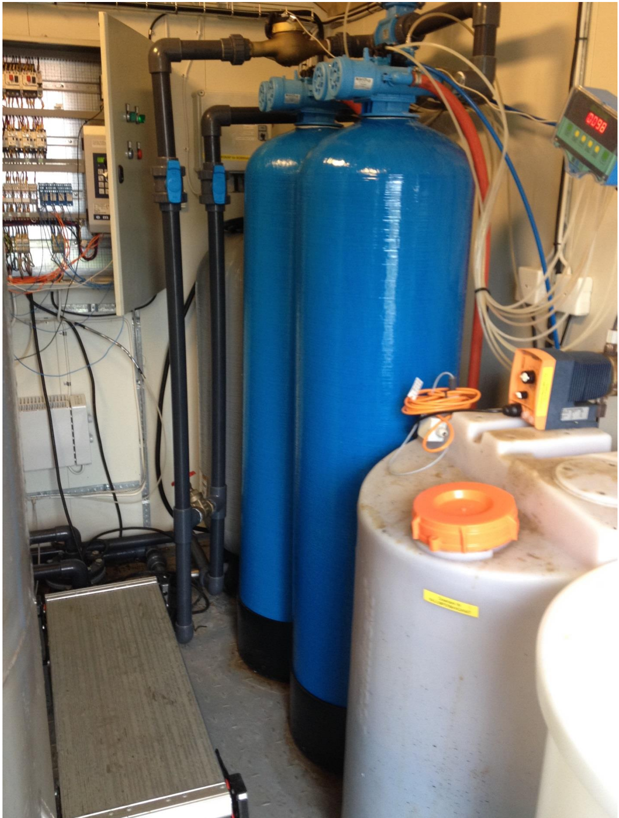
Grå trycktank (knappt synlig) Avhärtningskolonner Kaliumpermanganat-tank Salttank för regenerering av avhärtningskolonner
